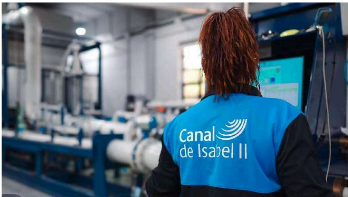
Estas instalaciones están afectadas por su envejecimiento natural. Imagen: Comunidad de Madrid
